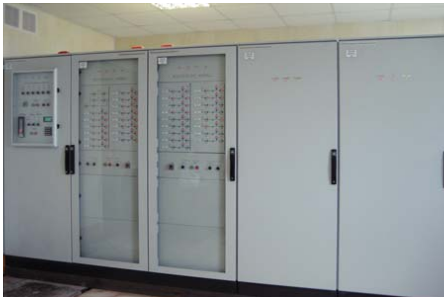
Рис. 4. Шкафы с аппаратурой САУ ГСП
