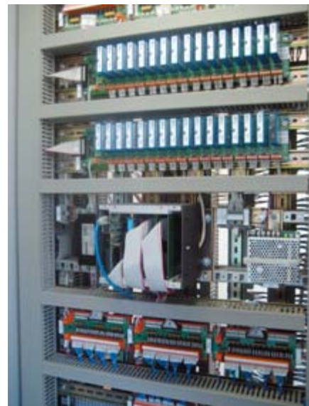
Рис. 5. Контроллер MicroPC установлен в каждом шкафу САУ ГСП
