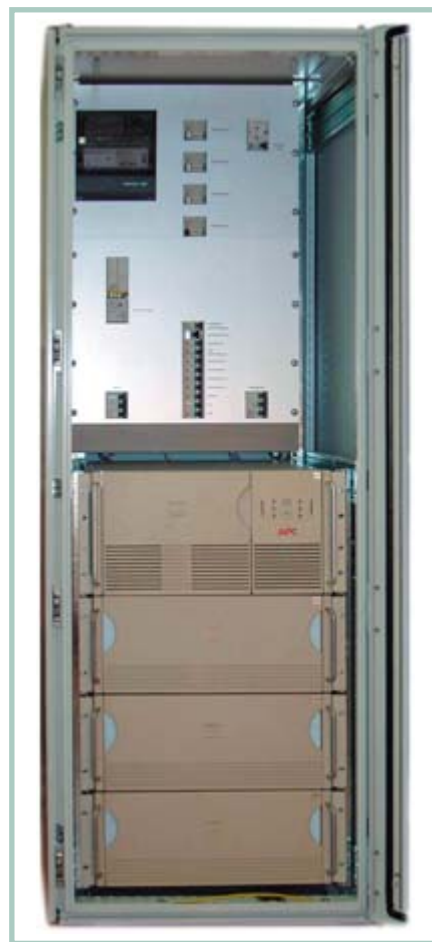
Рис. 3. Щит распределительный САУ ГРС
