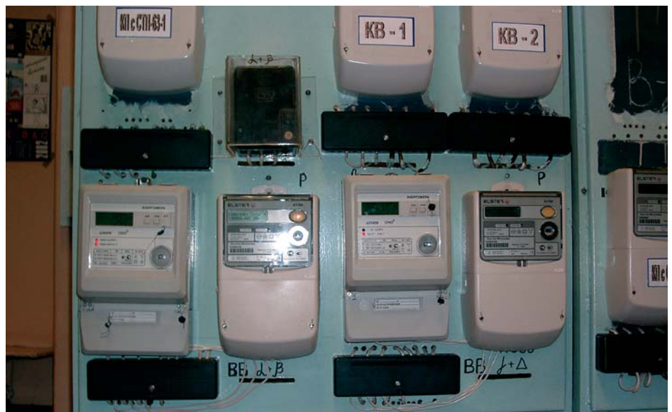
Расположение счетчиков на панелях подстанций
