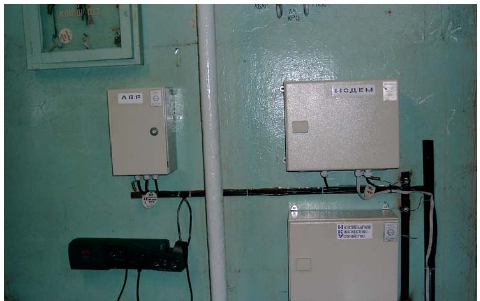
Размещение шкафов АСКУЭ на подстанции Сокольнической линии Московского метрополитена
