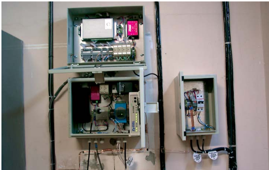
Обеспечение удобного доступа к оборудованию АСКУЭ
