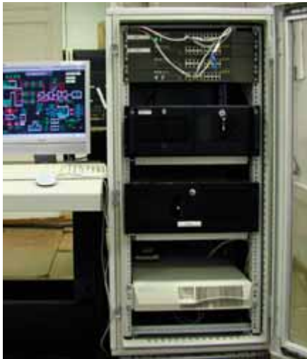
Рис. 7. Общий вид шкафа
