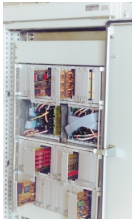
Рис. 4. Стойка поездной аппаратуры
